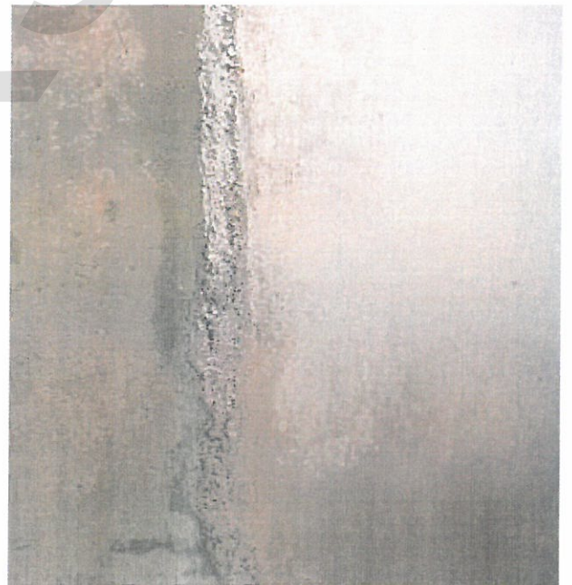
Трещина в кромке заделки фланца (100%)
