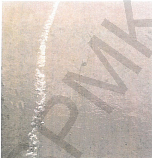
Трещина у заделки (83,3 %)
